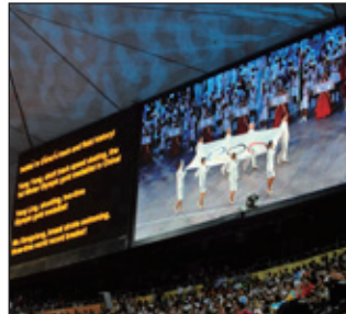
● 大型影像显示装置
